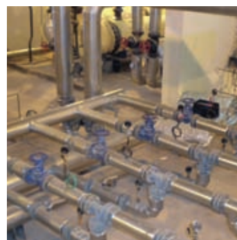
Теплообменник-смеситель АФТ. Котельная, пос. Мирный
