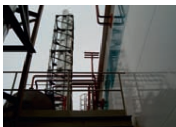
Поставка оборудования «ARI-Armaturen» для завода по переработке нефти «Волховнефтехим» (заказчик – ООО «Волховнефтехим»)
