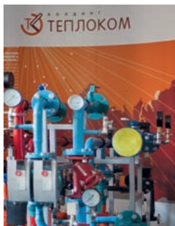
Блочный индивидуальный тепловой пункт
