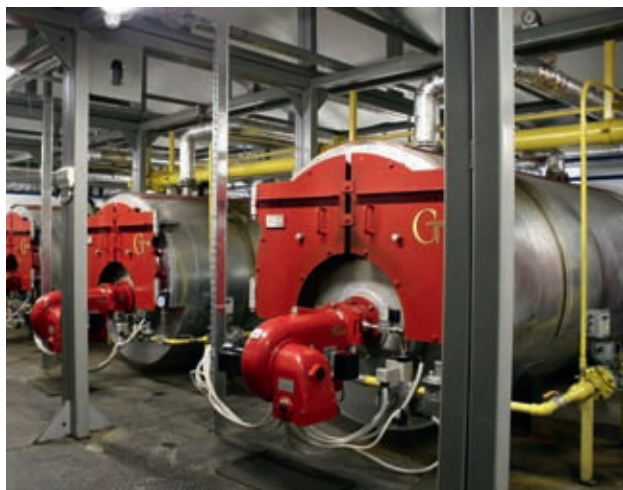
Автоматизированная блочно-модульная котельная
