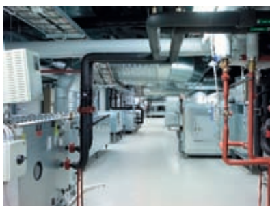
Технический этаж промышленного здания. Венткамера
