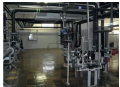
Центральный тепловой пункт МЭИ
