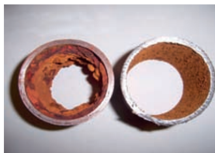
Санкт-Петербург. Изменение внутренней поверхности трубы ХВС через год работы устройства
