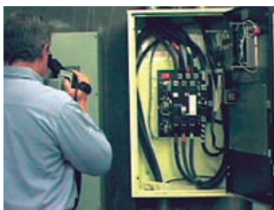
Термографическое обследование электрооборудования
