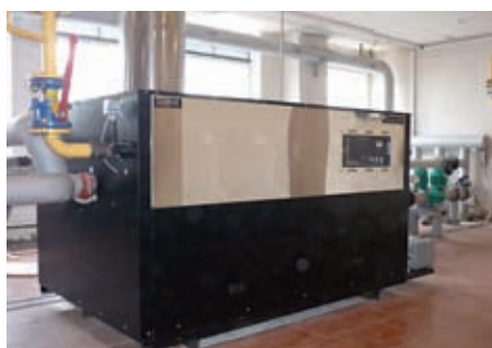
Административно-торговый комплекс «КОВЧЕГ» (Саратов), поставка водогрейных котлов для котельной
