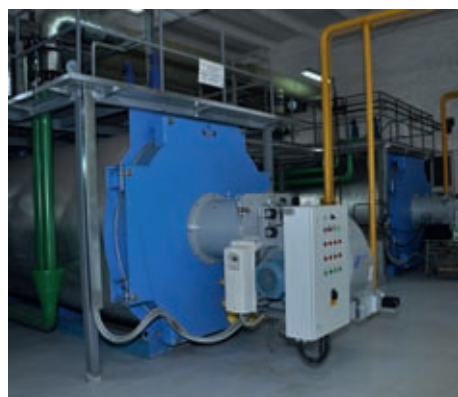
Котельная мощностью 29 МВт, ФГУ ОК «Бор» Управление делами Президента Российской Федерации
