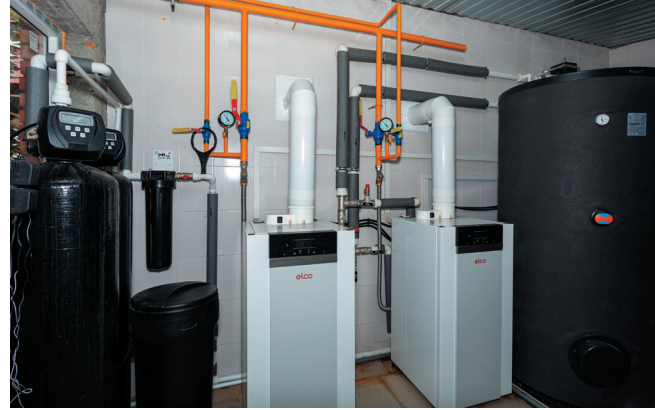
■ Котельная гостиничного комплекса «Даховская Слобода» в Адыгее
