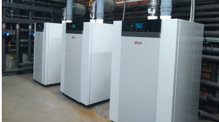
■ Котельная производства «Глассформ» в Гусь-Хрустальном
