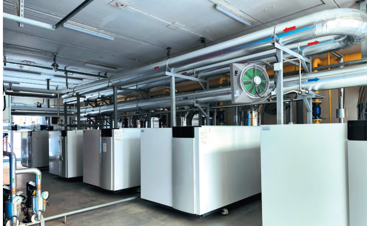
■ Рис. 2. Котельная с котлами ELCO
