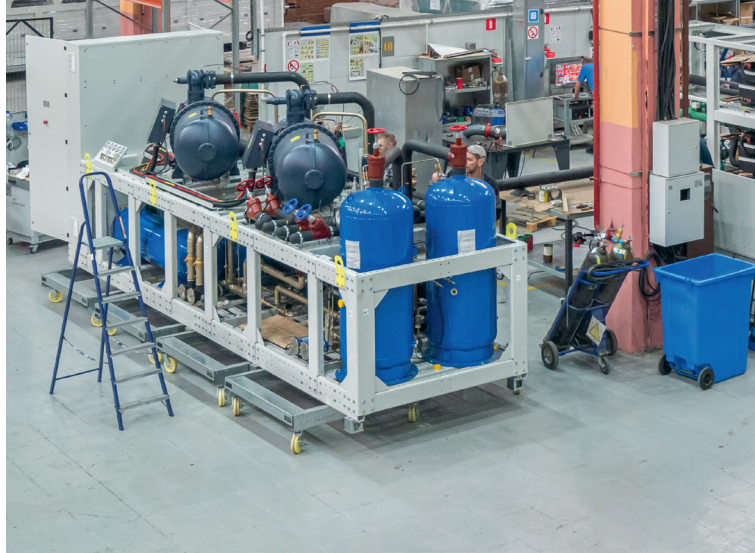
■ Сборка чиллера на базе винтовых компрессоров
