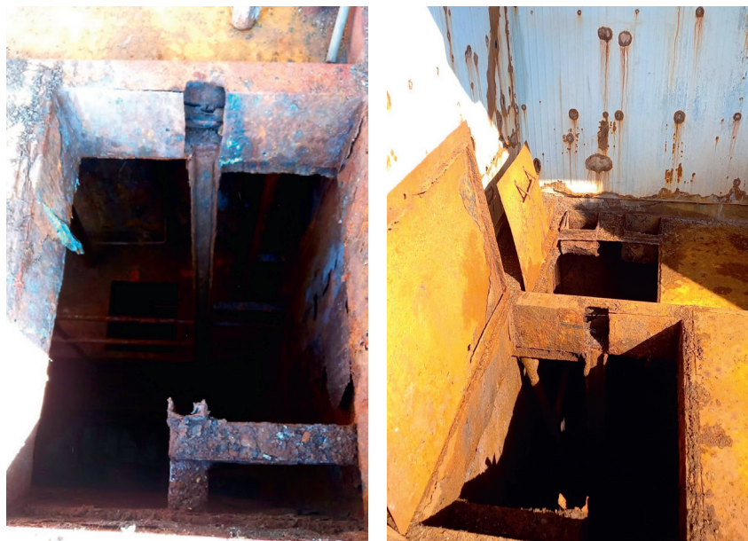
Рис. 3. Ограждающие конструкции КНС сельского поселения. Высокая степень коррозии. Пример отсутствия управления техническим состоянием конструкций
