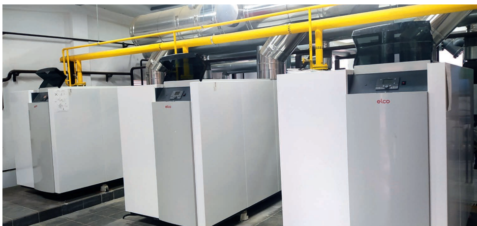
■ Котельная ЖК «Меркато»
