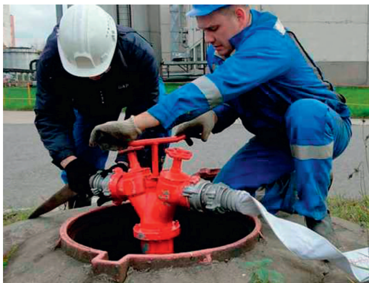
Рис. 1. Пожарная колонка с присоединенными пожарными рукавами установлена на подземный гидрант
