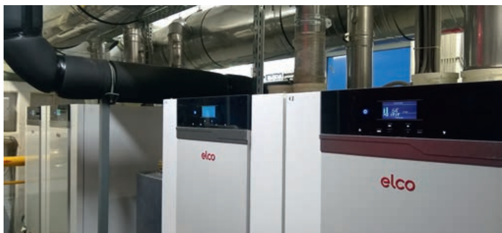
■ Каскад из восьми котлов THISION L PLUS в крышной котельной ЖК «На Московском», Тюмень
