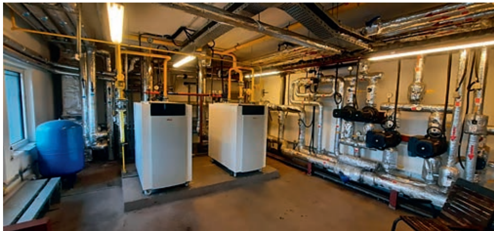
■ Два котла TRIGON XL в крышной котельной отеля Ibis, Калининград
