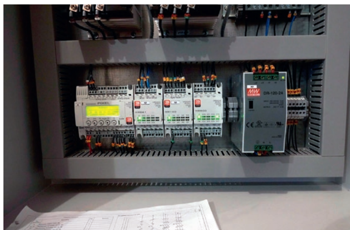
Рис. 4. Шкаф автоматизации с контроллером (левый нижний элемент)
