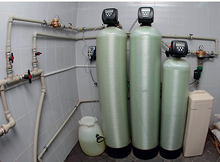
Фильтры засыпного типа
