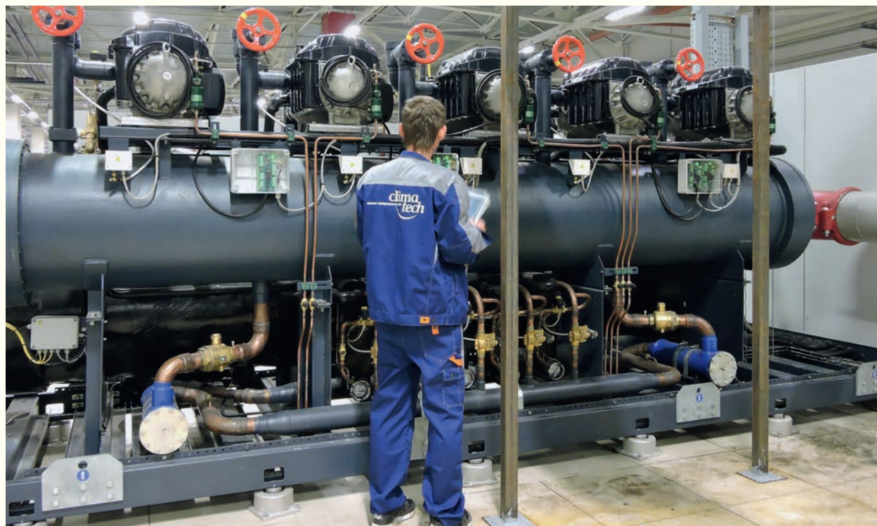
■ Система холодоснабжения для кондитерской фабрики КДВ в Воронеже
