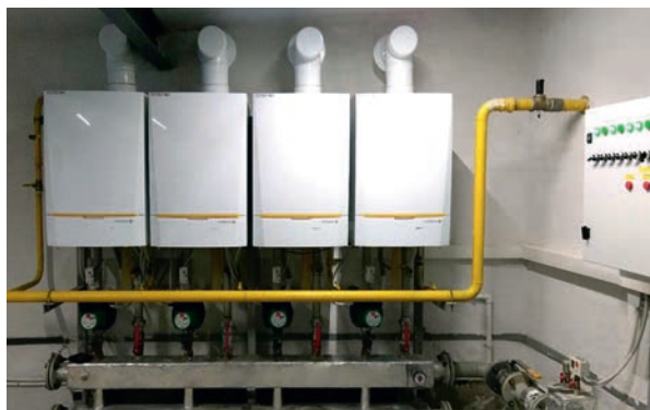
■ Каскадная система из четырех котлов INNOVENS PRO MCA 90 мощностью 340 кВт
