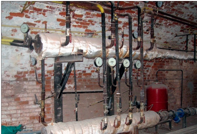
■ Рис. 2. Подающий и обратный коллекторы систем отопления
