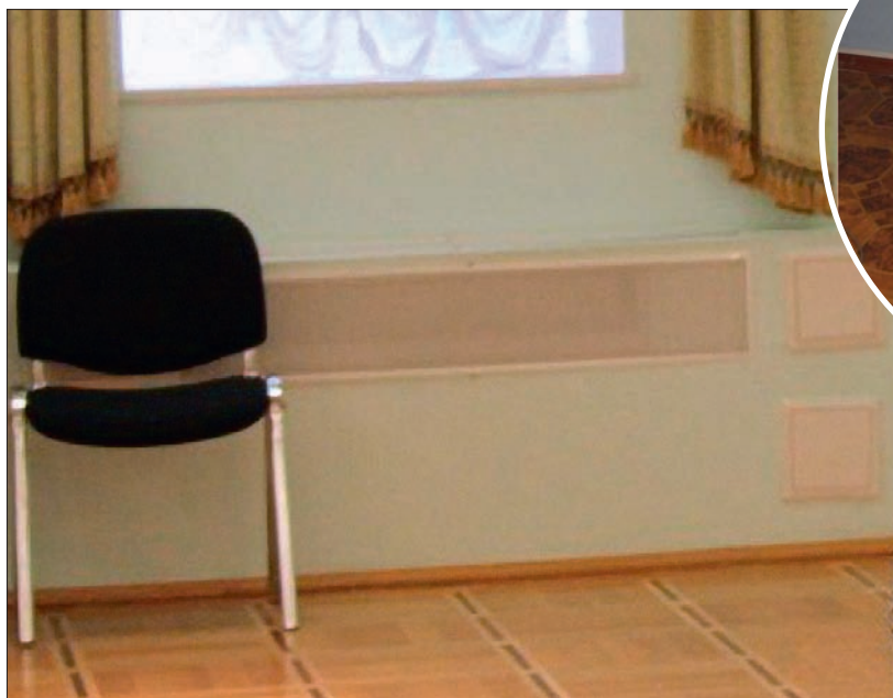
■ Рис. 3. Вид на доводчики в подоконном пространстве и способ их подключения (на выноске)
